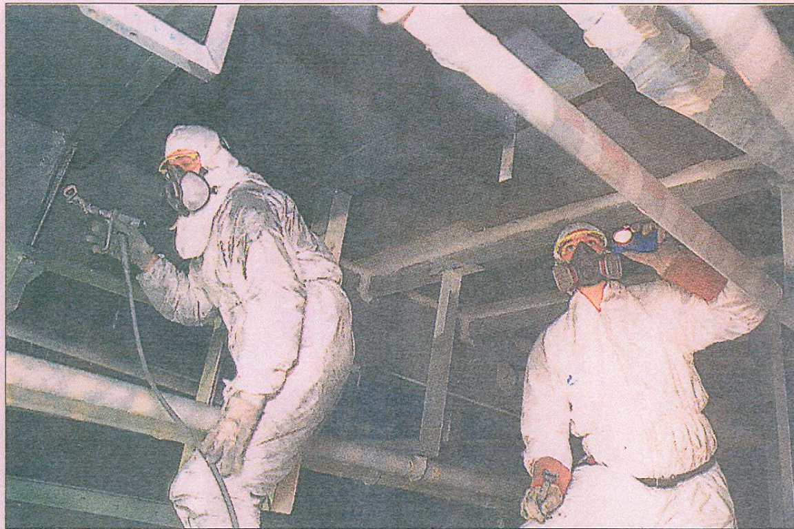
FJERNER RUST: Rustfjerning, høytrykksspyling og sprøytemaling. Dette er noen av arbeidsoppgavene firmaet Dalseide & Fløysand nå trenger flere ansatte til å ta seg av.
